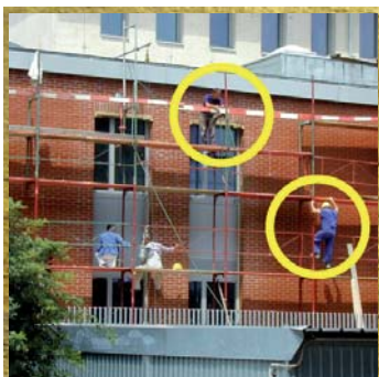
Gerüst mit Sicherheitsmangel
